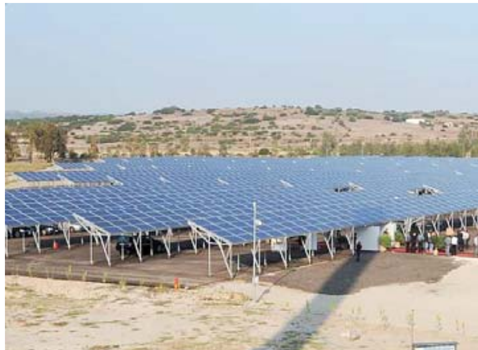
Il parco fotovoltaico di Ottana
